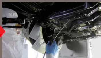
無公害な油性浸透剤「ブラウン」を既存穴から空洞部分に塗布(約0.5~0.75ℓ)
